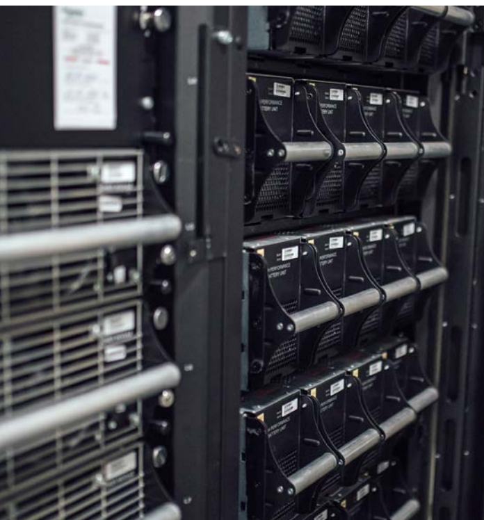
Die Daten werden auf den eigenen Servern gesichert, welche sich im sicheren Bereich des Gebäudes befinden. PHOTO: ZVG
